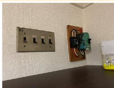
新築時の分電盤
